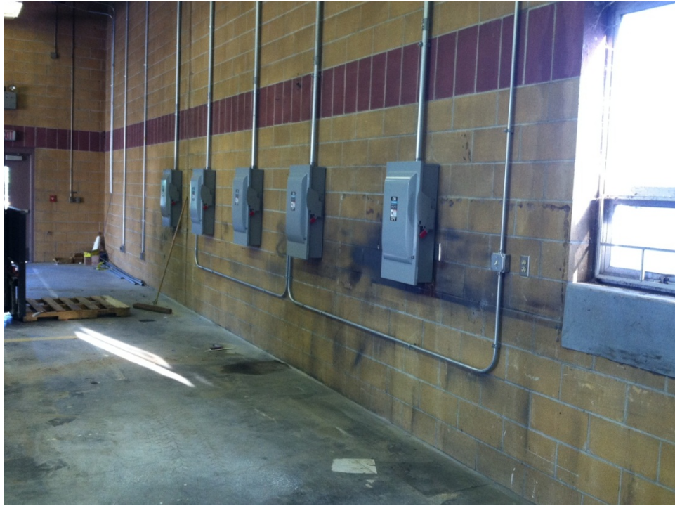
EKTC Garnett electrical
