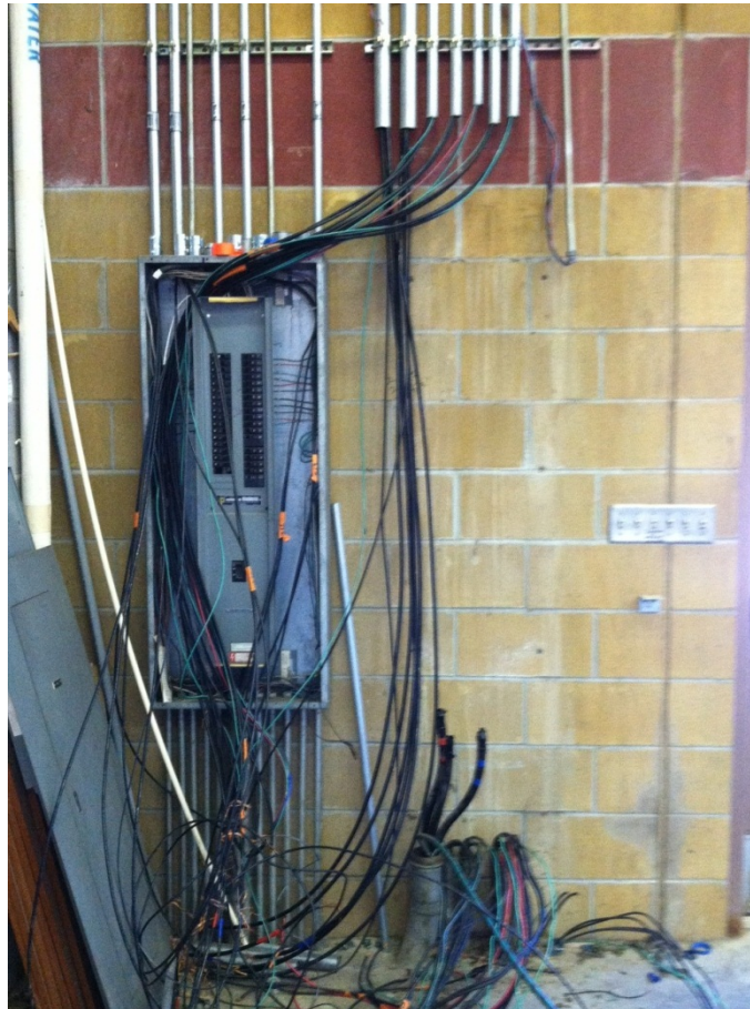
EKTC Garnett electrical
